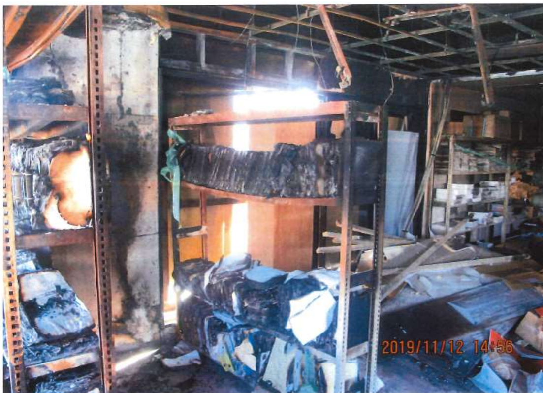
火災の現場写真
